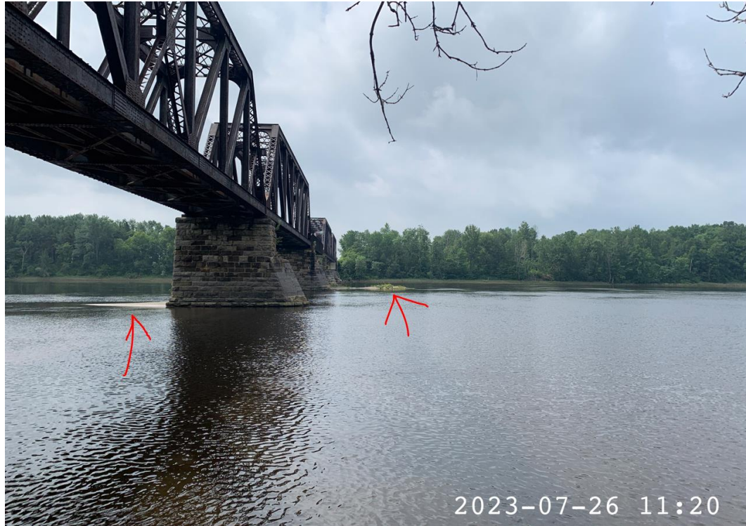
Figure 3.10 : Bancs d'accumulation sous le pont ferroviaire
