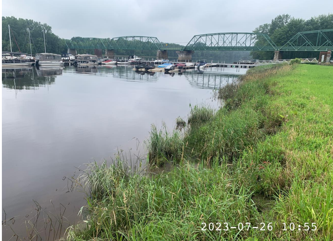
Figure 3.6 : Fissuration et décrochement de la rive (zone 2)
