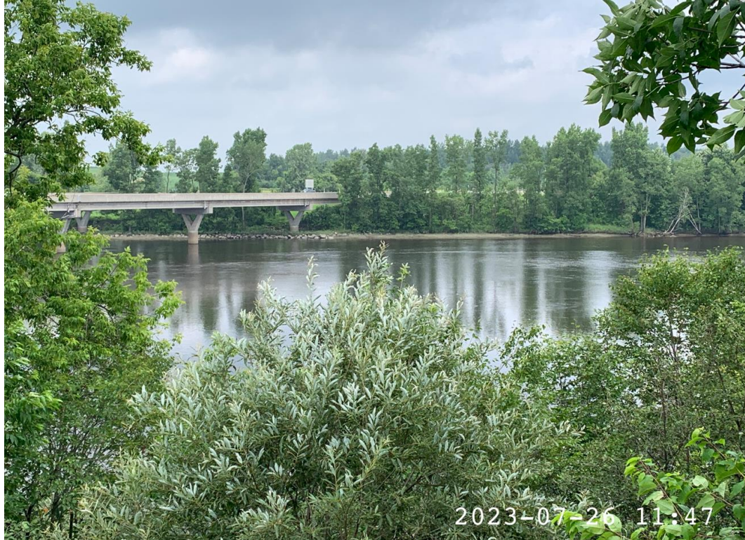
Figure 3.7 : Empierrement et érosion en rive nord (zone 4)
