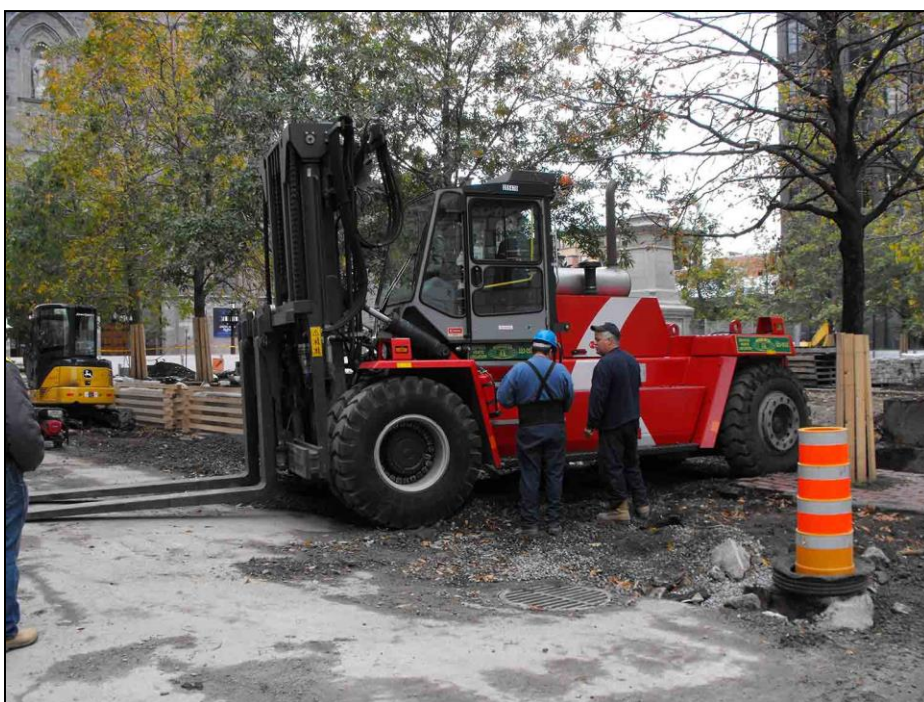
Photo 13 : Soulèvement d'arbre et transport avec élévateur à fourche [source: NFU , projet de la Place d'Armes , Montréal]
