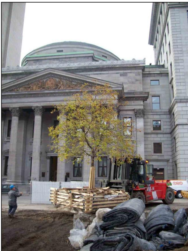
Photo 12 : Soulèvement d'arbre et transport avec élévateur à fourche [source: NFU , projet de la Place d'Armes , Montréal]
